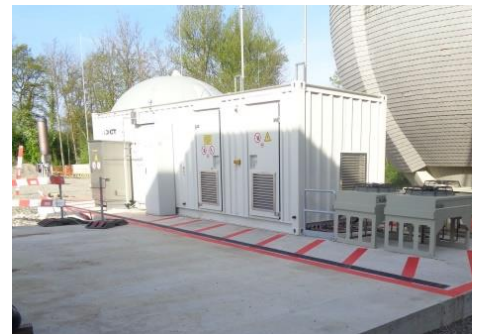
Installation de traitement du biogaz
