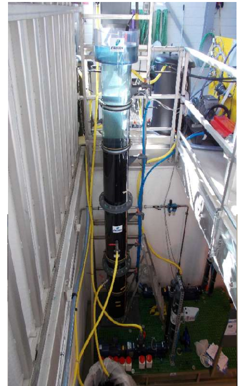
Installation pilote du CarboPlus®
