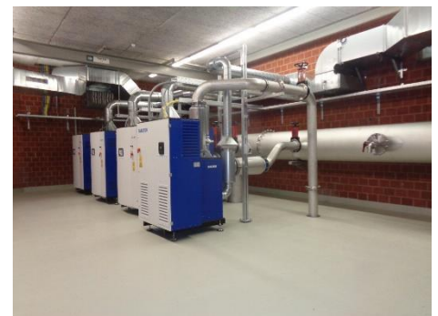
Station de surpresseurs avec turbocompresseur
