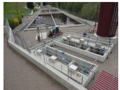
Bassins de contact de l'étape MP et silo de stockage du CAP
