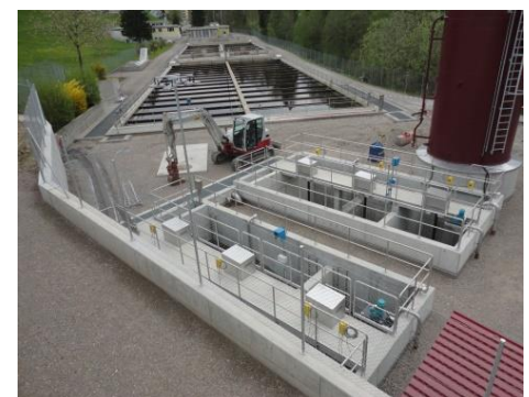
Reaktionsbecken der PAK-Stufe mit PAK-Silo
