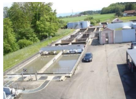
Site de la STEP avec le bâtiment de filtration en arrière-plan
