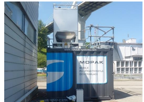
Mobile PAK-Dosieranlage (Schaub) für Versuche
