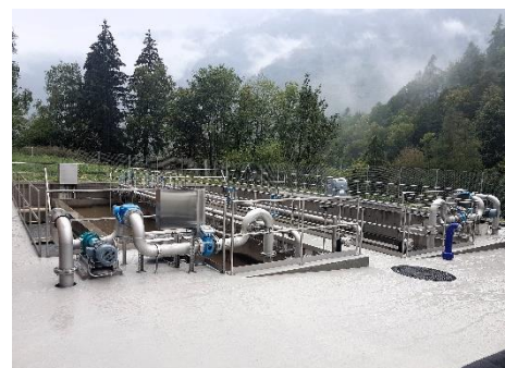
Nouveau bloc de bassins avec biologie des boues activées
