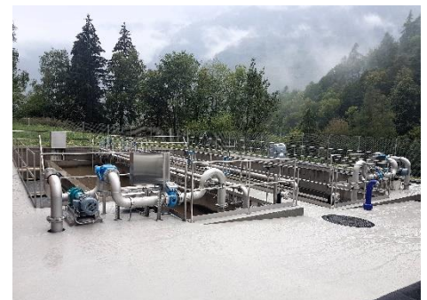
Neuer Beckenblock mit Belebtschlammbiologie
