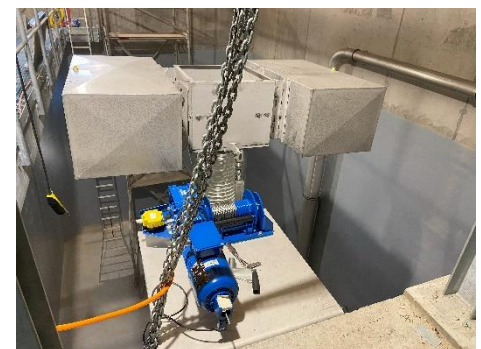
Décanteur dans le bassin SBR
