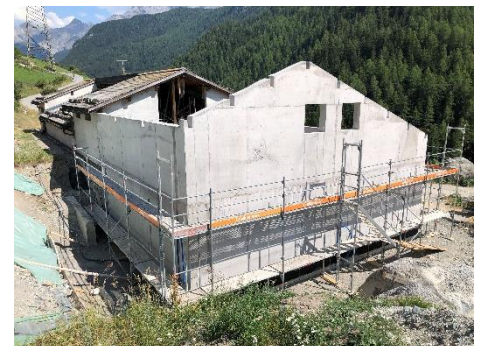
Anbau für die SBR-Biologie
