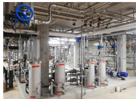
Installations avec unités de filtration
