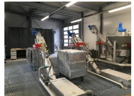
Blick auf die neuen Rechen und Sandwaschanlage
