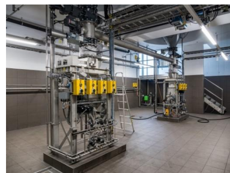
Installation pour le dosage du CAP et production de la suspensions eau-CAP
