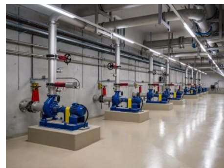
Pompes de recirculation des boues CAP
