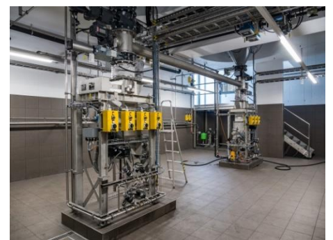
Anlage zur Dosierung vom PAK und Herstellung einer PAK-Wasser-Suspension
