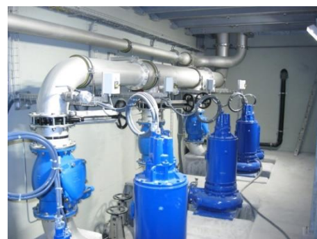
Station de pompage des eaux usées brutes
