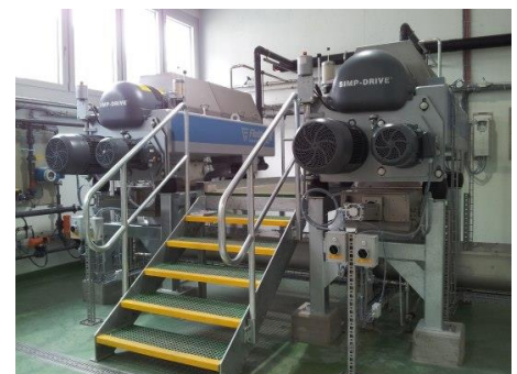
Déshydratation des boues
