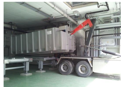
Benne à boues avec vis intégrée de répartition des boues déshydratées
